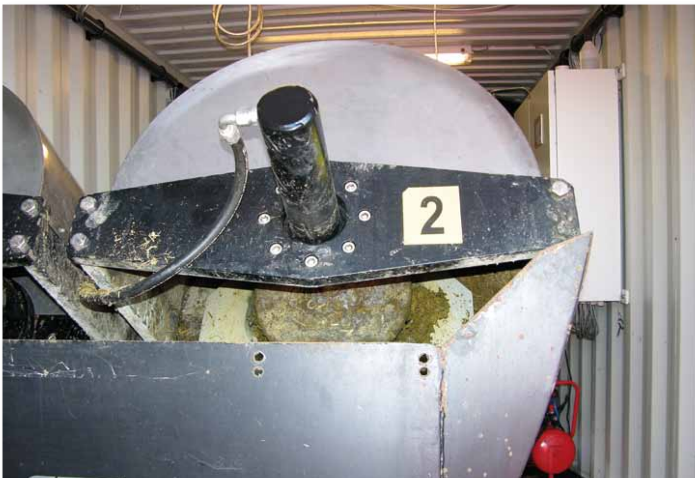
Engineerings gyllesepareringsanlæg indbygget i en container er installeret på malkekobedrift i Himmerland.
