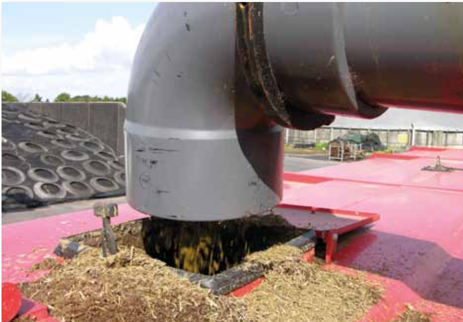
Fiberfraktionen fra SB Engineerings gyllesepareringsanlæg opsamles i en lukket container inden transport til biogasanlægget.
